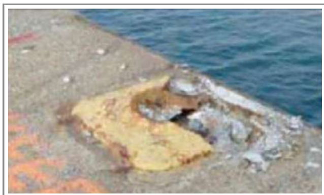
Marca de la posición de la Bita dañada Fuente: The Nautical Institute www.nautinst.org
